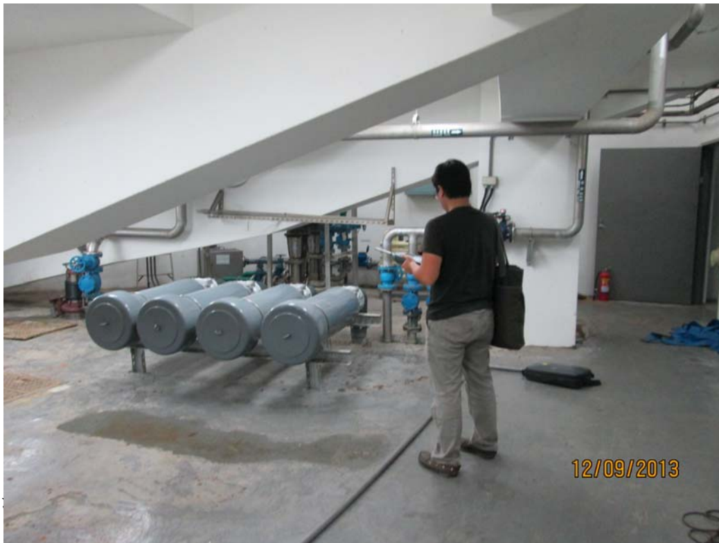
學資中心污水處理設施噪音源-鼓風機
